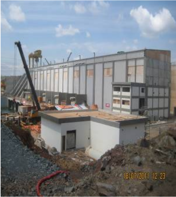
Bujagaali HPP: Power House
